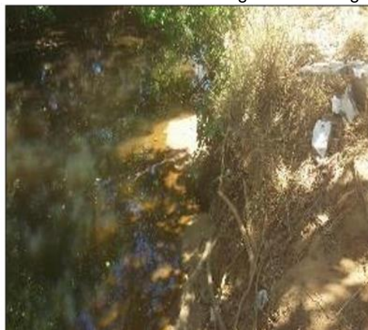
Figura 2.37 - Retirada da vegetação, assoreamento e lixo nas margens do córrego.
