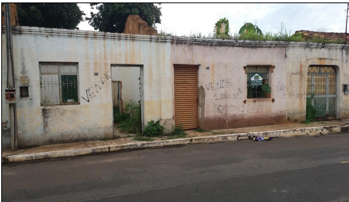
Figura 9. Imóvel abandonado localizado no centro histórico de Porto Nacional - TO
