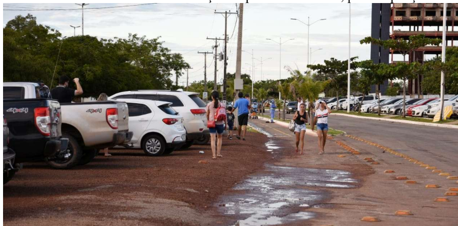
Figura 71 - Palmas: trecho em obras da revitalização da praia da Graciosa, para ampliação da ciclovia, 2019
