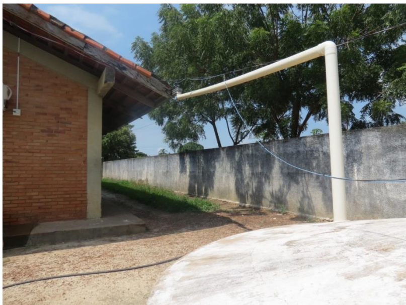
Figura 6: Estrutura de captação de água pluvial na escola E7
