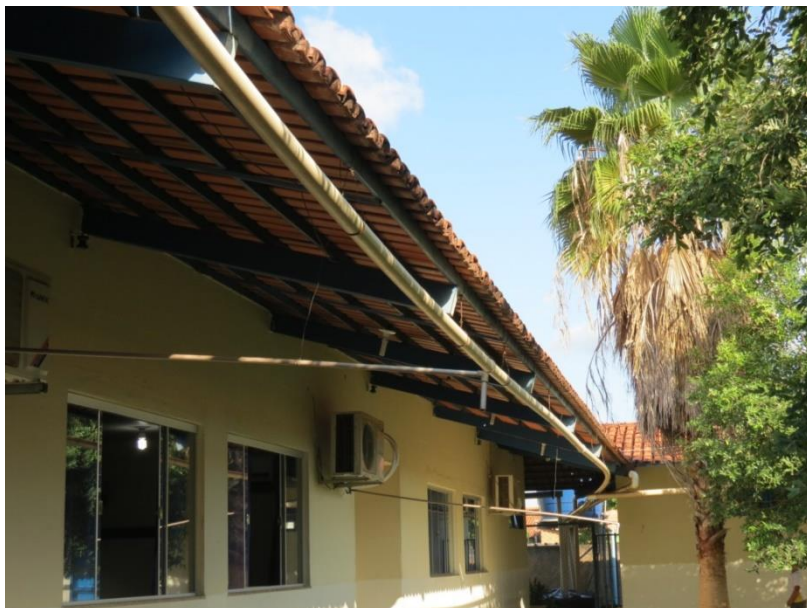
Figura 5: Estrutura de Captação de água pluvial na escola E2
