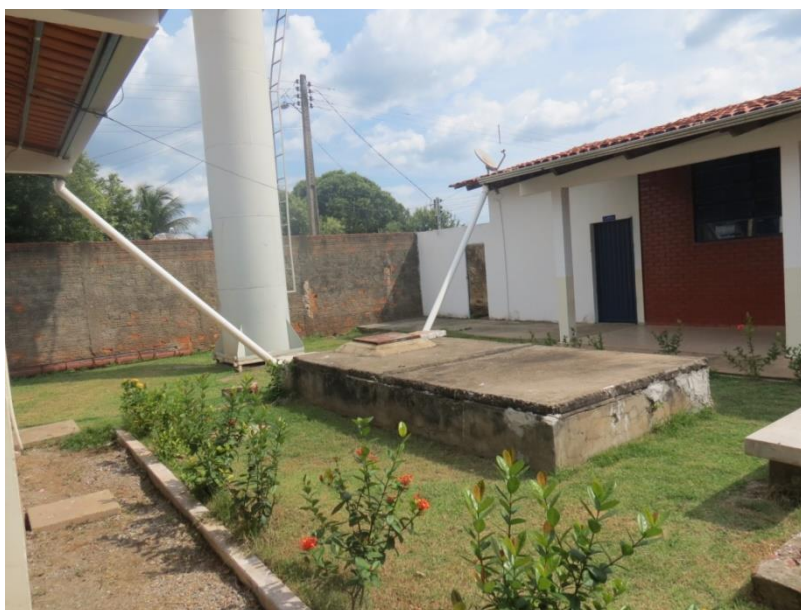
Figura 2: Captação de água da chuva utilizada nos serviços de limpeza da escola- E8 1
