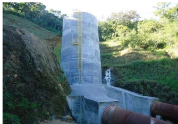
Figura 10 – Chaminé de equilíbrio da PCH de Nova Fátima
