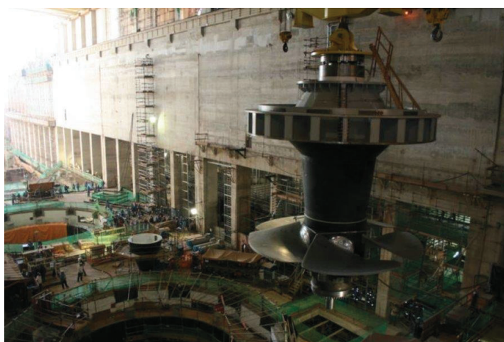
Figura 11 – Casa de força da UHE de Estreito
