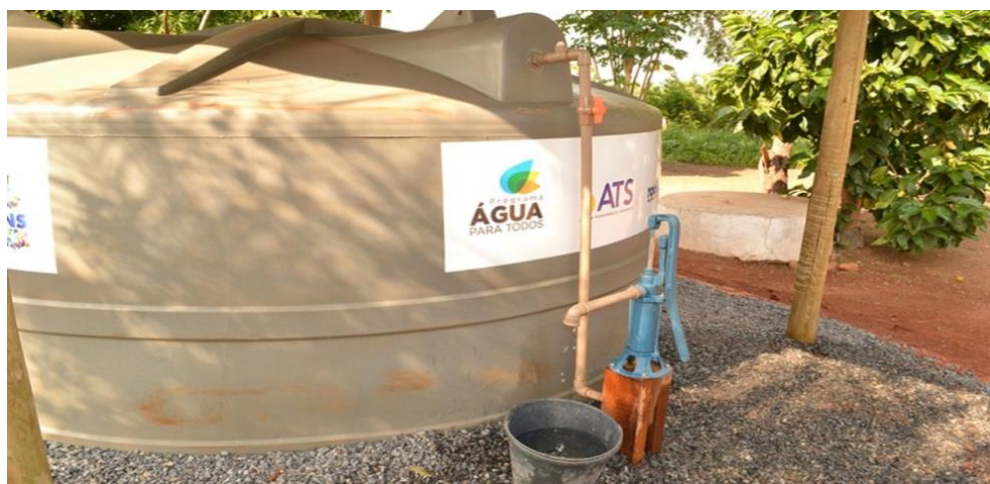
Figura 6 - cisterna rural com bomba – Aurora do Tocantins, 2018.
