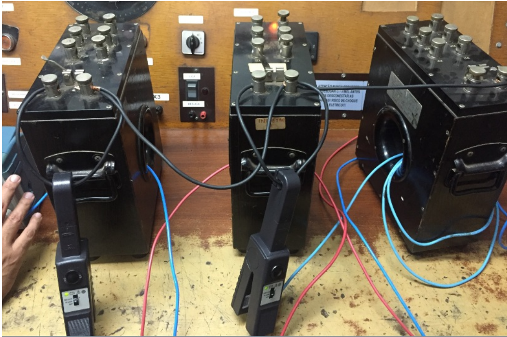
Figura 5.11 – Transformadores de corrente para medição.
