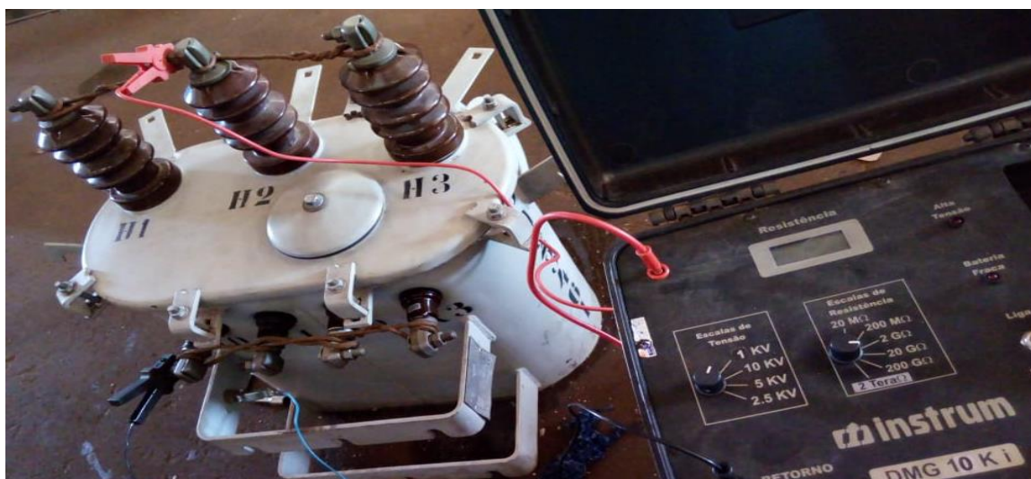
Figura 26 – Medição de isolamento do trafo com OVI
