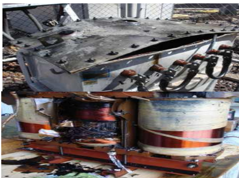
Figura 13 - Falha em transformador com óleo vegetal - explosão sem incêndio
