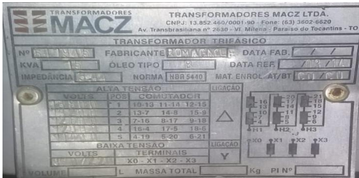
Figura 25 – Dados de placa do trafo em teste com OVI
