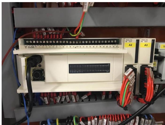
Figura 60 - CLP Schneider e Módulos de Extinção Analógicos
