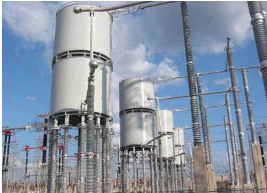
Figura 12 – Reator Limitador de Corrente da SE de Tucuruí 500 kV.
