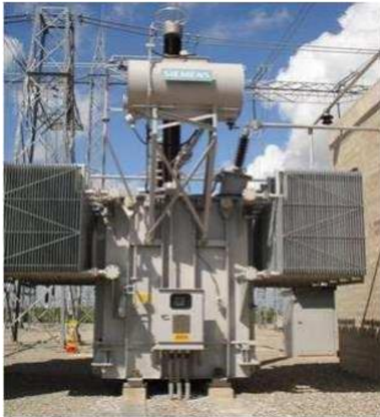
Figura 10 – Reator shunt de 765 kV instalado na subestação de Foz do Iguaçu.
