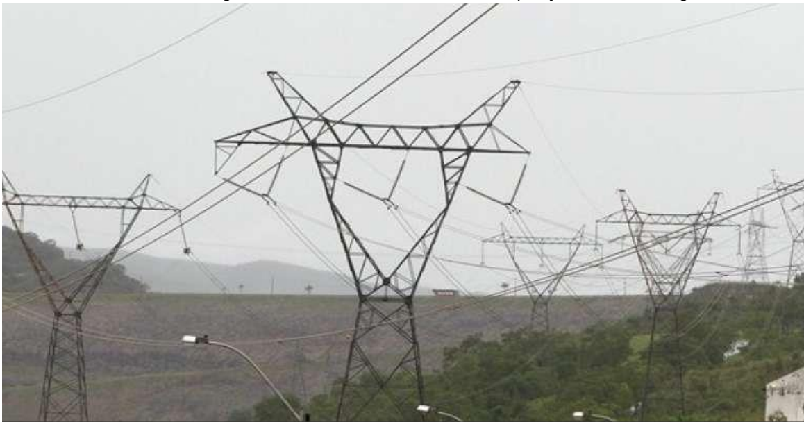
Figura 13 – Torre de transmissão com disposição de fases triangular.
