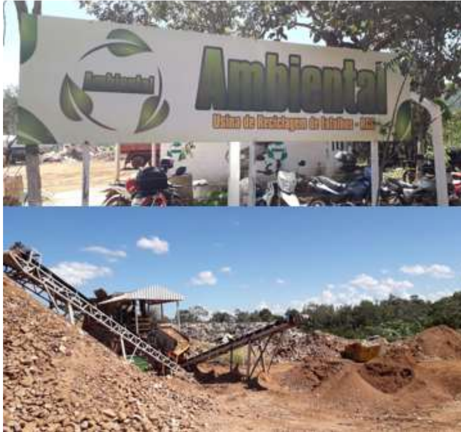
Figura 16- Usina de Reciclagem de Entulhos – RCC de Palmas-TO
