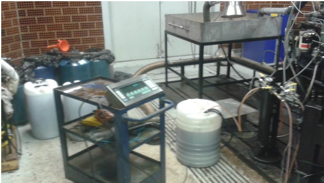
Figura 35 - Sistema de Alimentação a Biodiesel
