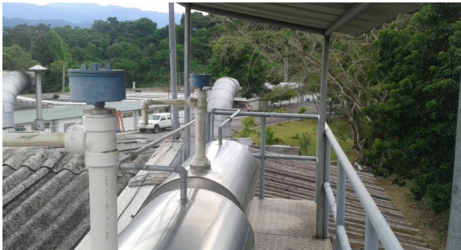
Figura 33 - Reservatório de Combustíveis a Diesel
