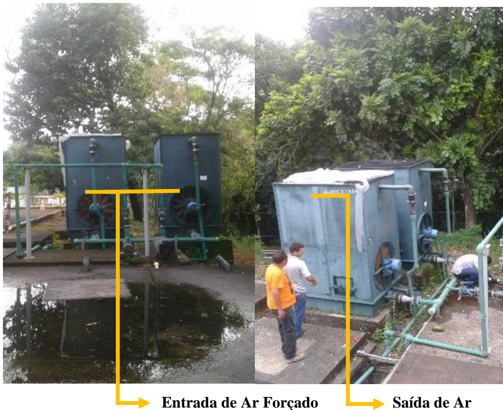
Figura 26 - Torre de Resfriamento
