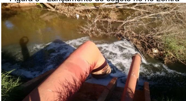
Figura 3 - Lançamento de esgoto no rio Lontra
