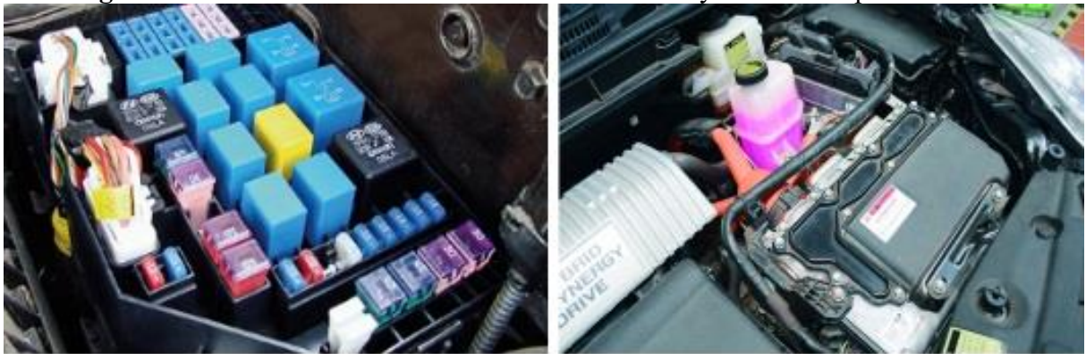
Figura 16 - Caixa de relés e sistema de controle do Toyota Prius respectivamente.
