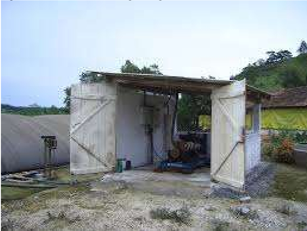
Figura 10 - Motor Gerador à Biogás abrigado
