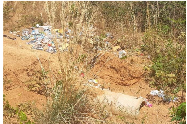
Figura 23 - Erosão da cabeceira do afluente – obras de pavimentação da avenida LO 18 (798619; 8873251)
