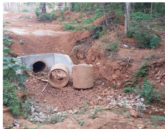
Figura 27 - Erosão do curso d'água Córrego Cachimbo - AVU Parque Linear Urbano Água Fria (794209; 8876416)
