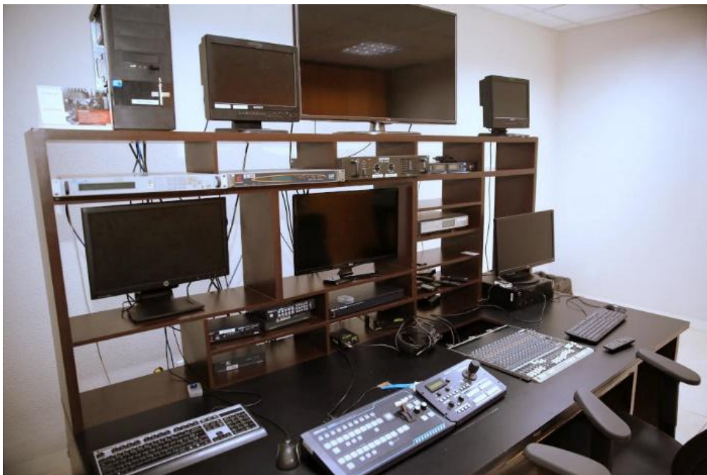
Figura 6. Ilha de corte da Esmat – equipamentos de controle.
