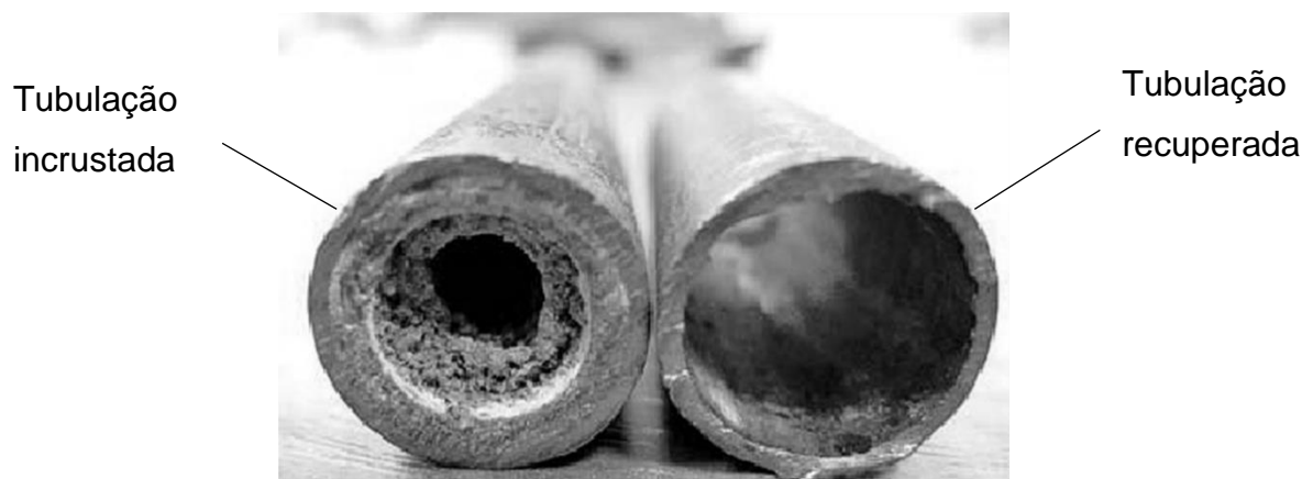
Figura 5 - Incrustação de carbonato de cálcio em tubulações de ferro fundido
