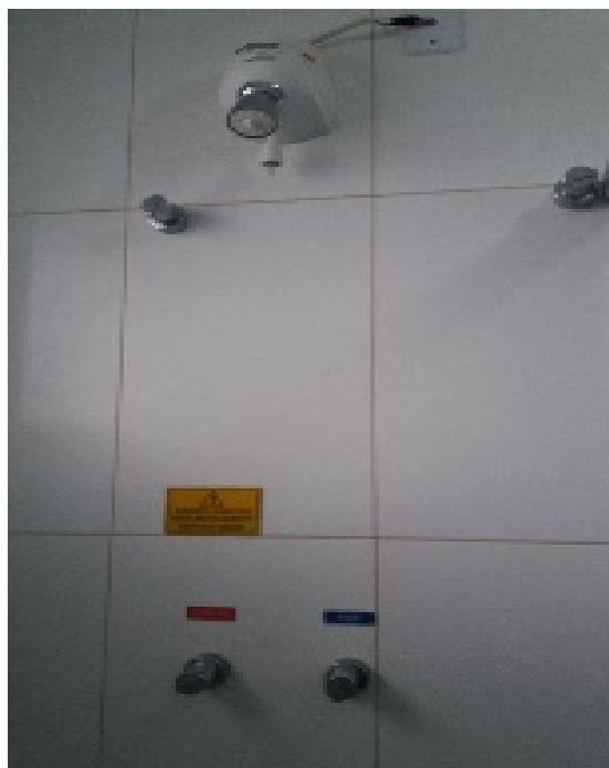
Figura 17: Chuveiro do banheiro
