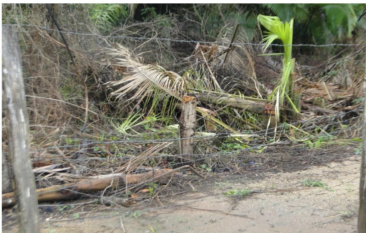
Figura 4. Cerca da área da ETA danificada.
