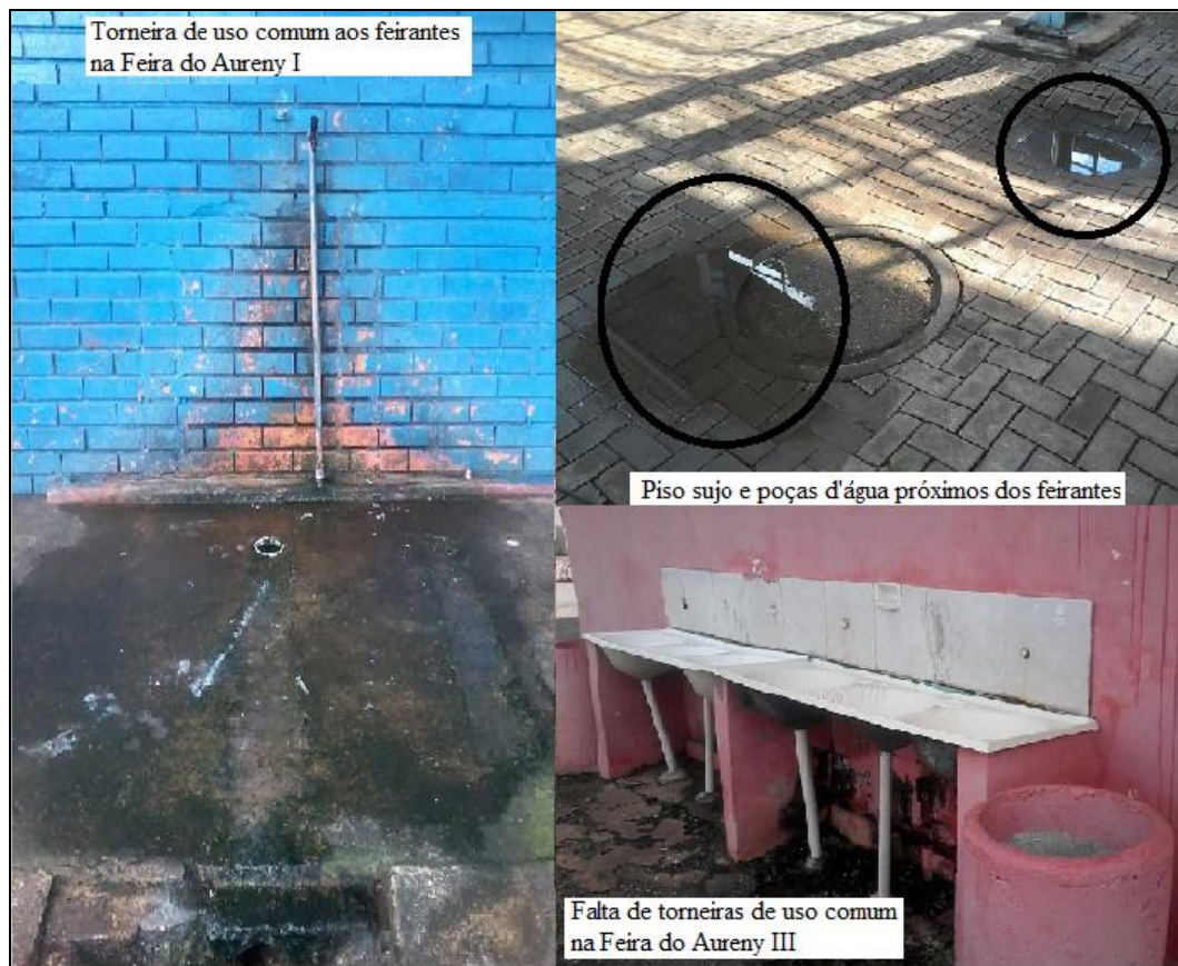
Figura 11 - Palmas: condições precárias das instalações de apoio nas feiras municipais
