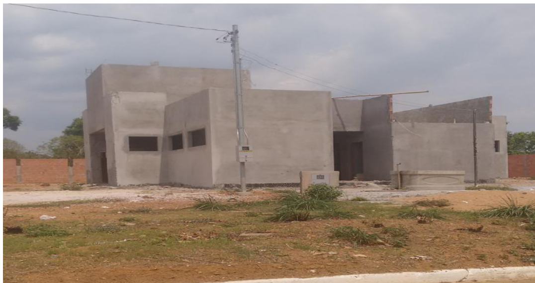
Imagem 12: Construção paralisada de um posto de saúde no Setor Brasil.
