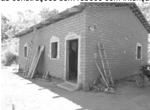
Figura 100 - Novas construções sem reboco com intenção do adobe a vista
