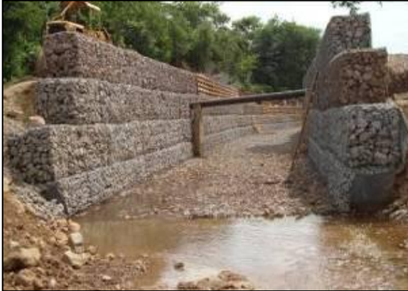
Figura 29 – Canalização do Córrego Pernada.
