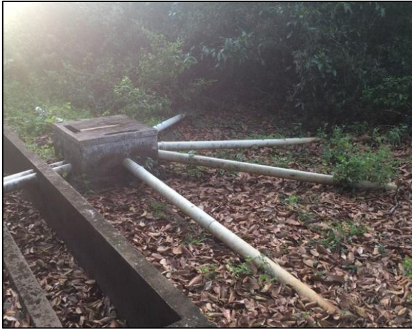
Figura 21 - Caixas de distribuição no solo.
