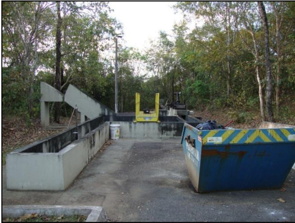
Figura 15 – Vista geral do Tratamento Preliminar.
