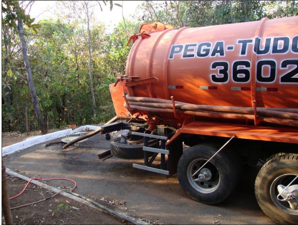
Figura 14 - Descarga de caminhão limpa-fossas na ETE.
