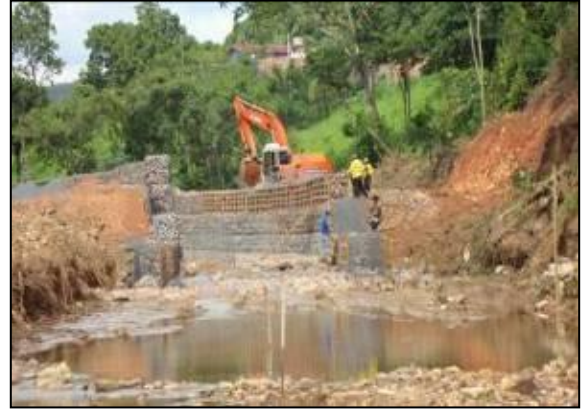
Figura 30 – Canalização do Córrego Pernada.
