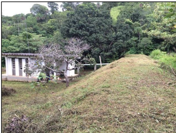
Figura 31 - Captação Córrego Pernada.
