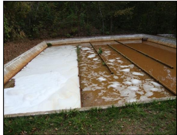
Figura 20 - Tanque de Contato (Desinfecção).
