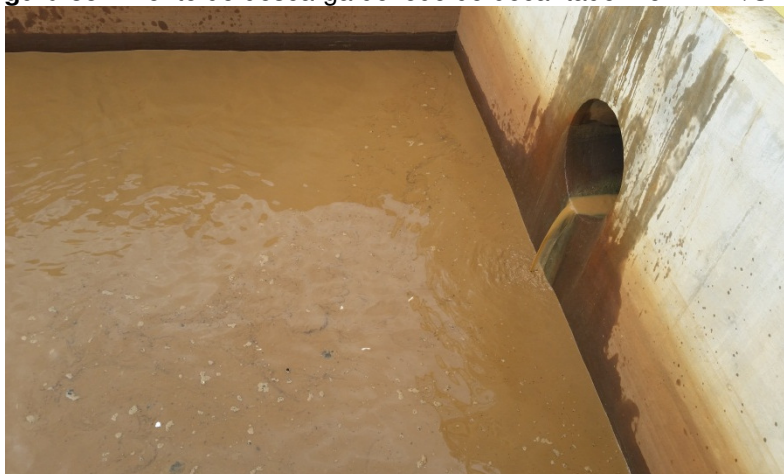
Figura 35 – Ponto de descarga do lodo do decantador no TRDD/SALF
