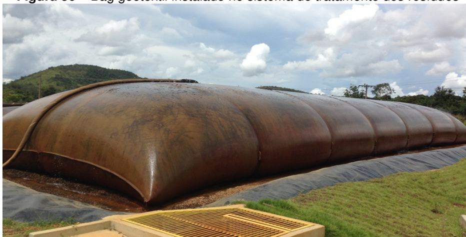
Figura 36 – Bag geotêxtil instalado no sistema de tratamento dos resíduos
