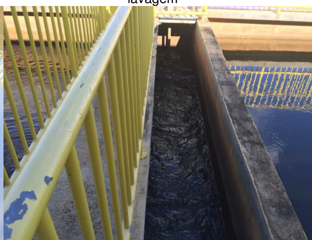
Figura 28 – Canal lateral condutor da água de lavagem
