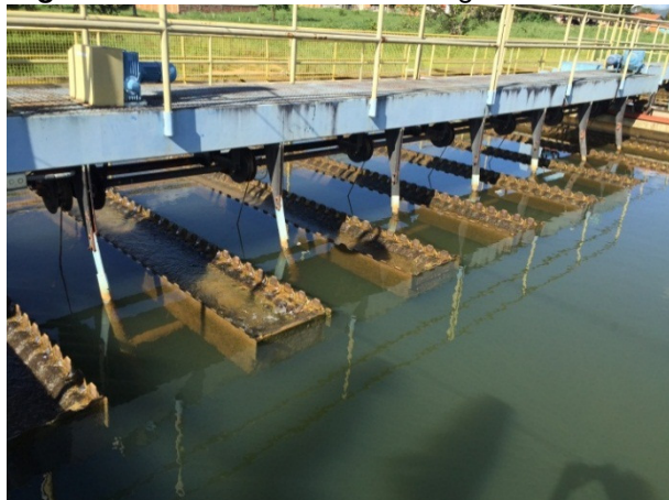
Figura 18 – Calhas de coleta de água decantada
