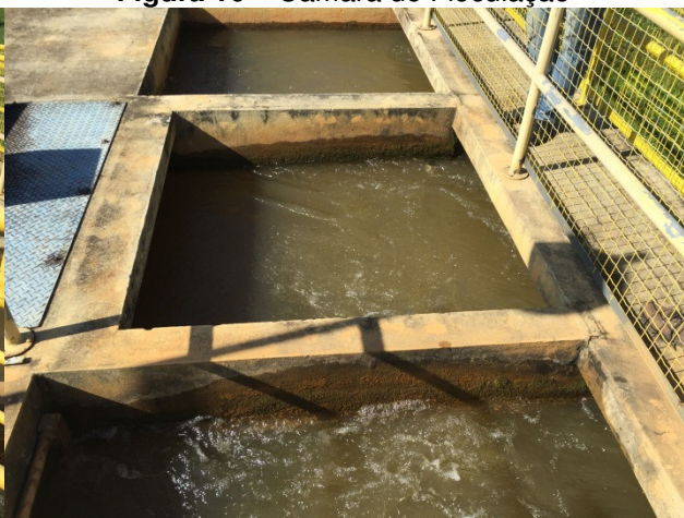
Figura 16 – Câmara de Floculação
