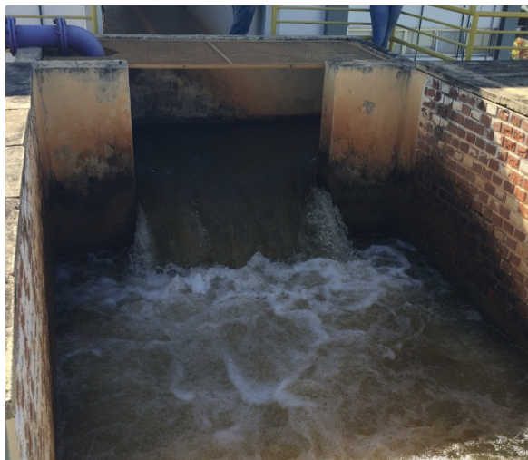
Figura 11 – Caixa de chegada da água bruta
