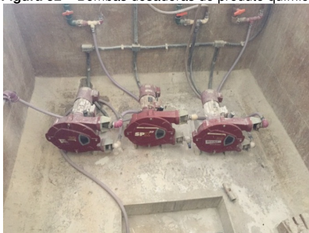
Figura 32 – Bombas dosadoras de produto químico
