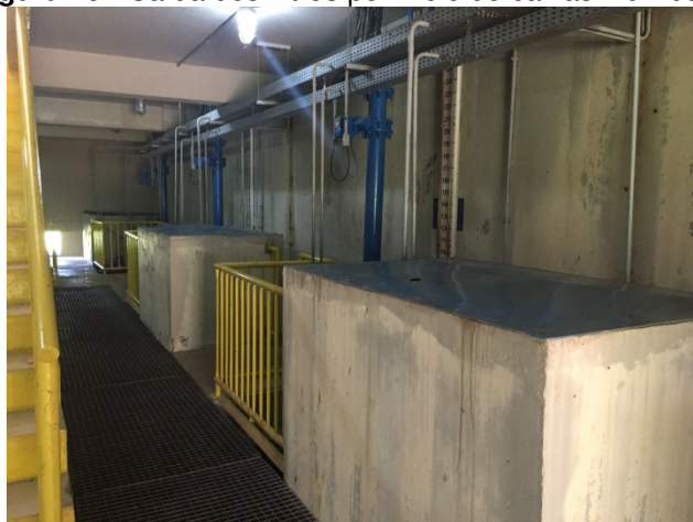
Figura 29 - Saída dos filtros por meio de caixas individuais
