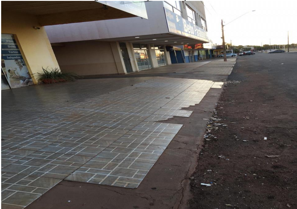
Figura 12- Condições do calçamento
