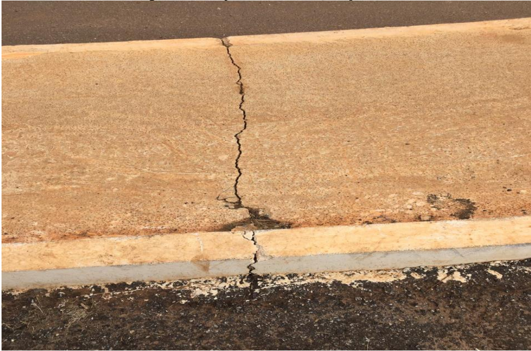
Figura 9- Comprometimento do calçamento
