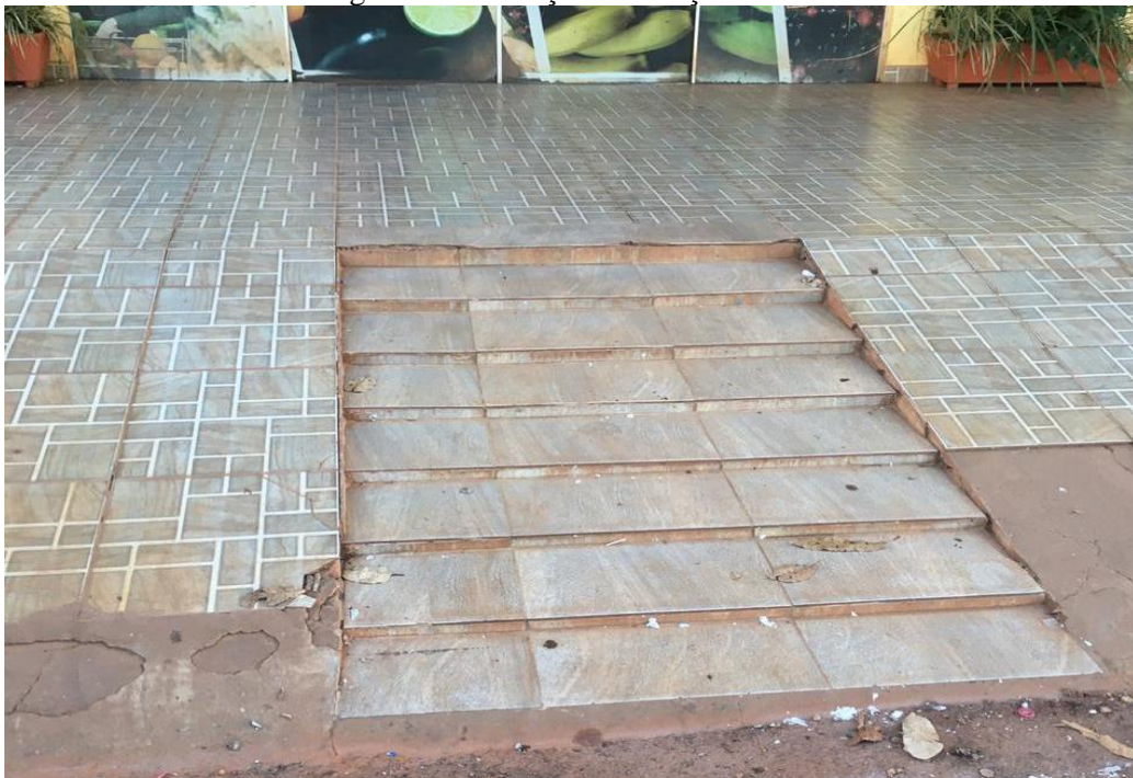
Figura 13- Condições do calçamento 2
