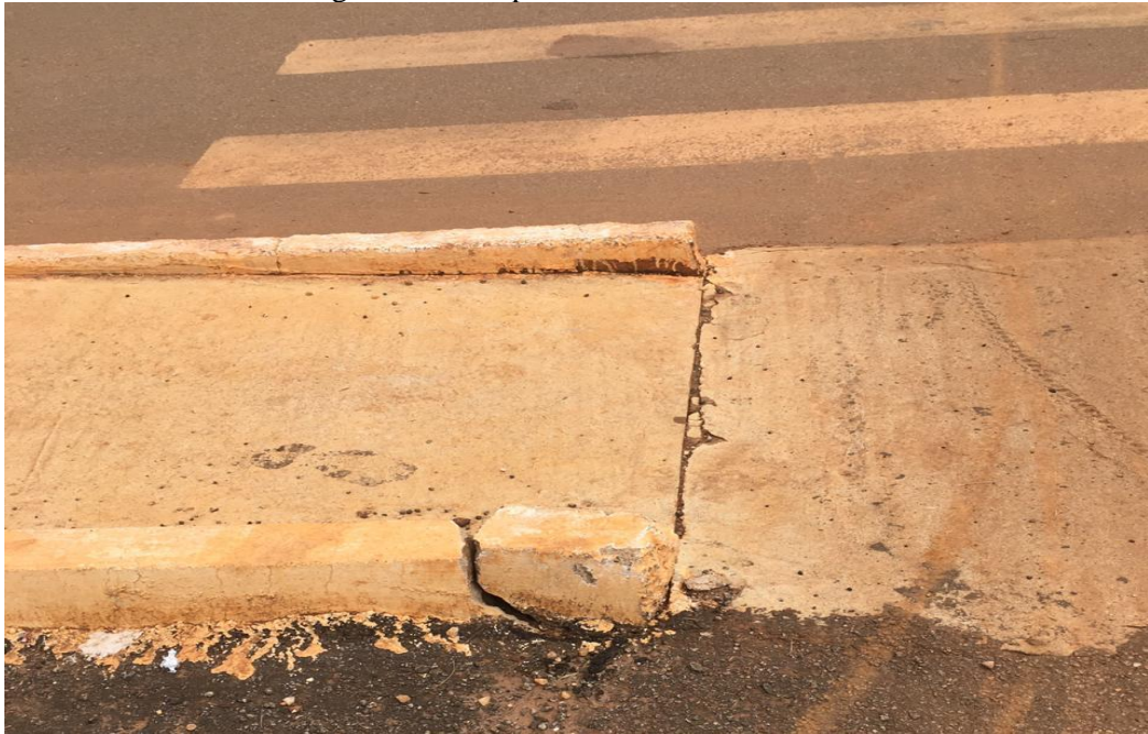
Figura 16- Comprometimento do meio fio
