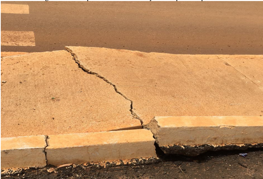
Figura 17- Comprometimento do calçamento ponto específico
