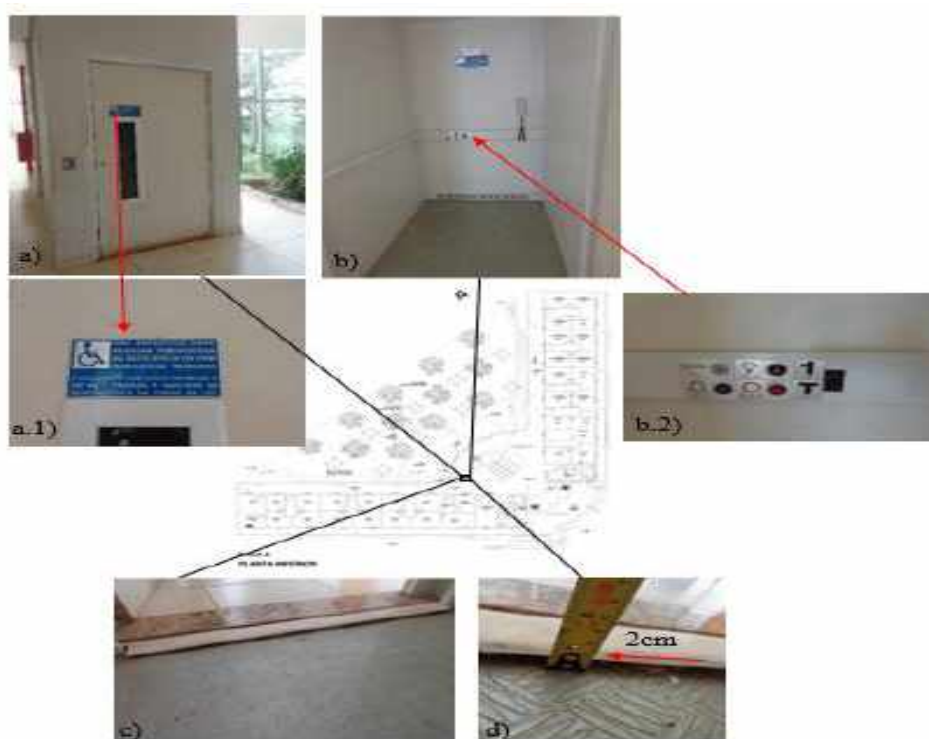
Figura 22 – Trecho A – Imagens da Plataforma elevatória Bala 2
