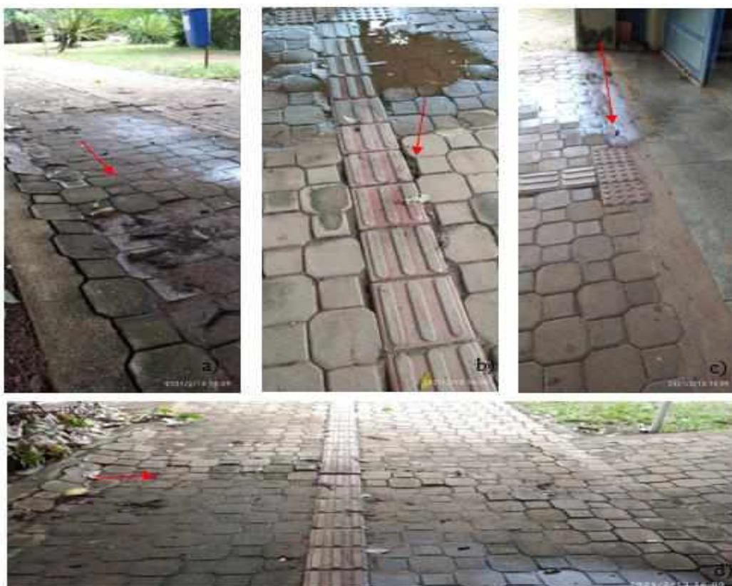
Figura 42 – Trecho C – Calçadas com pisos táteis, localizadas nas proximidades dos Blocos I, II e III.
