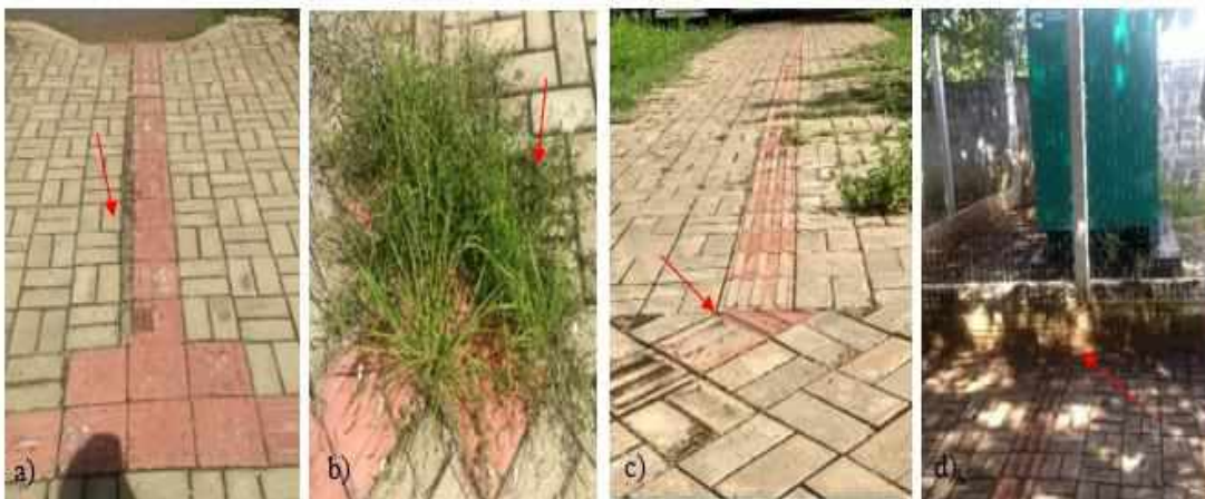
Figura 43 – Trecho C – Pisos táteis direcionais e de alerta no entorno do Bloco I
