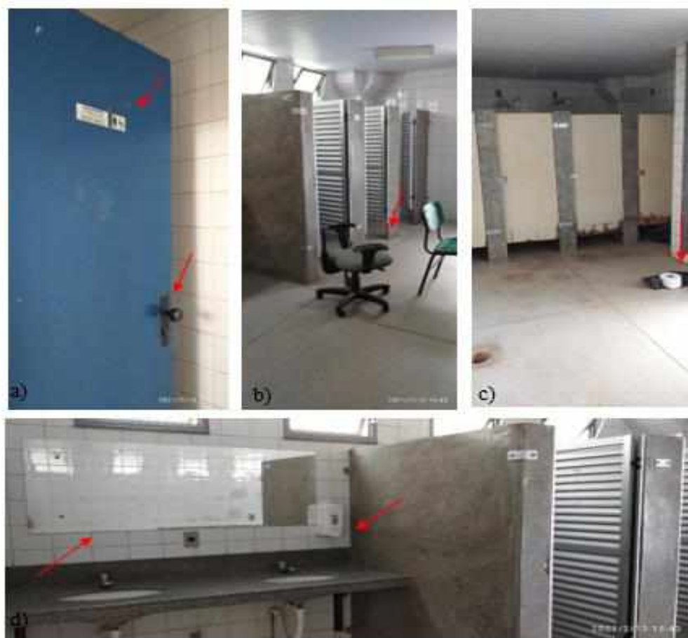
Figura 33 – Trecho C – Imagens do sanitário feminino do Bloco I, pavimento superior
