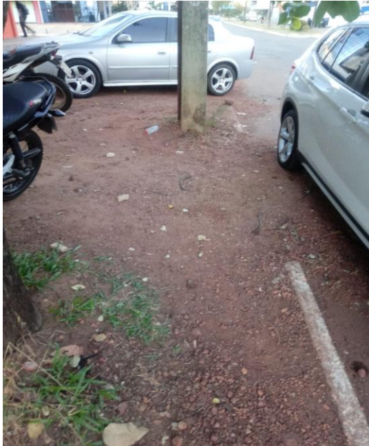
Figura 15 – Falta de calçamento
