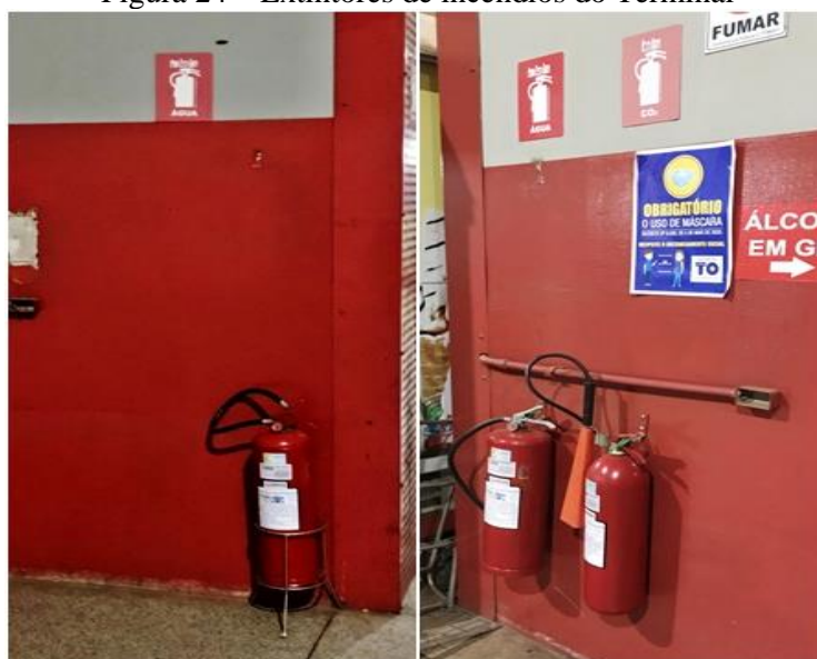
Figura 24 – Extintores de incêndios do Terminal
