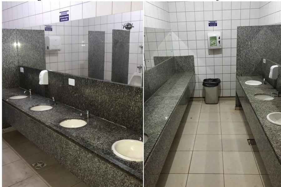
Figura 29 – Bancada de lavatórios e acessórios conjunto oeste
