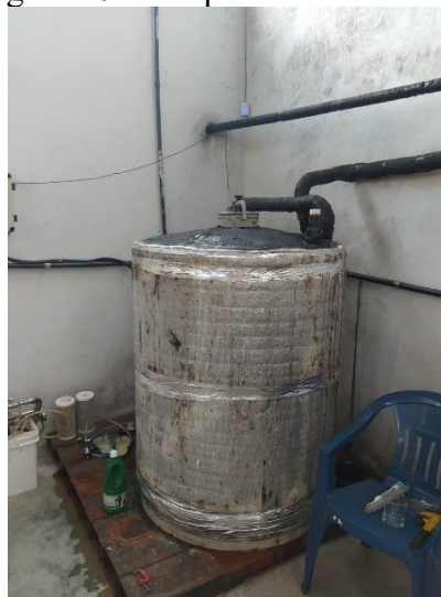
Figura 10 - Tanque de resfriamento.
