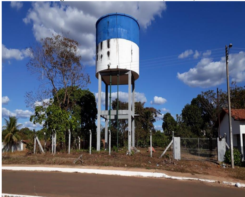
Figura 14: Reservatório Elevado (REL 001)
