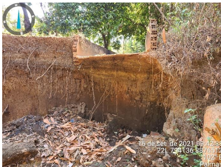
Figura 12. Canal de concreto que direciona a água pluvial para o interior da área da nascente
