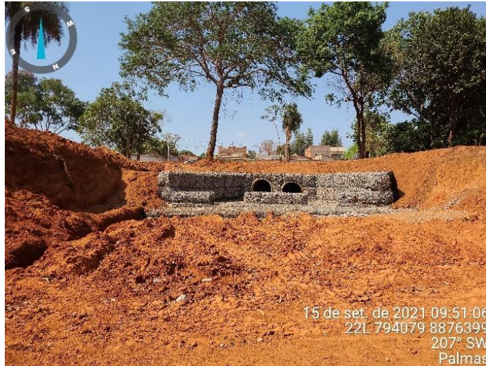
Figura 16. Sistema de lançamento de drenagem que atende ao Setor Santo Amaro I e II
