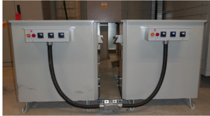
Figura 3.7: Transformadores de aterramento zig-zag instalados na USF-Mineirão. Fonte (Arquivo pessoal).
