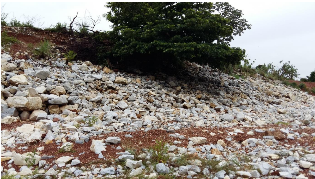
Figura 4.1 - Escorregamentos no talude a jusante da barragem Taboca.
