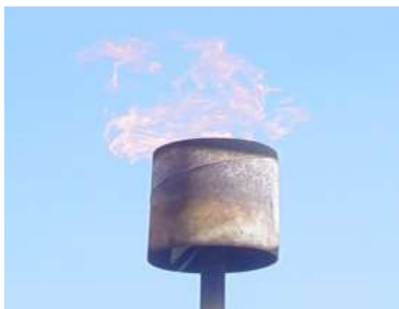
Figura 4. Queimador de biogás da ETE Vila União
