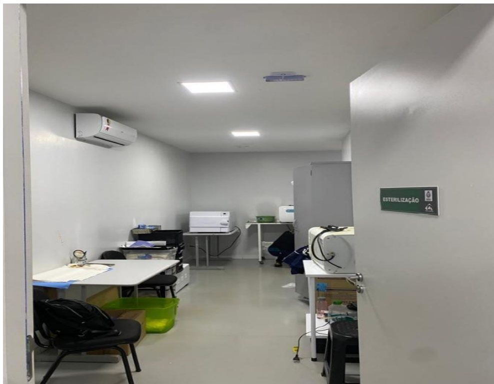
Figura 23: Sala de Esterilização do Hospital Veterinário Público de Brasília
