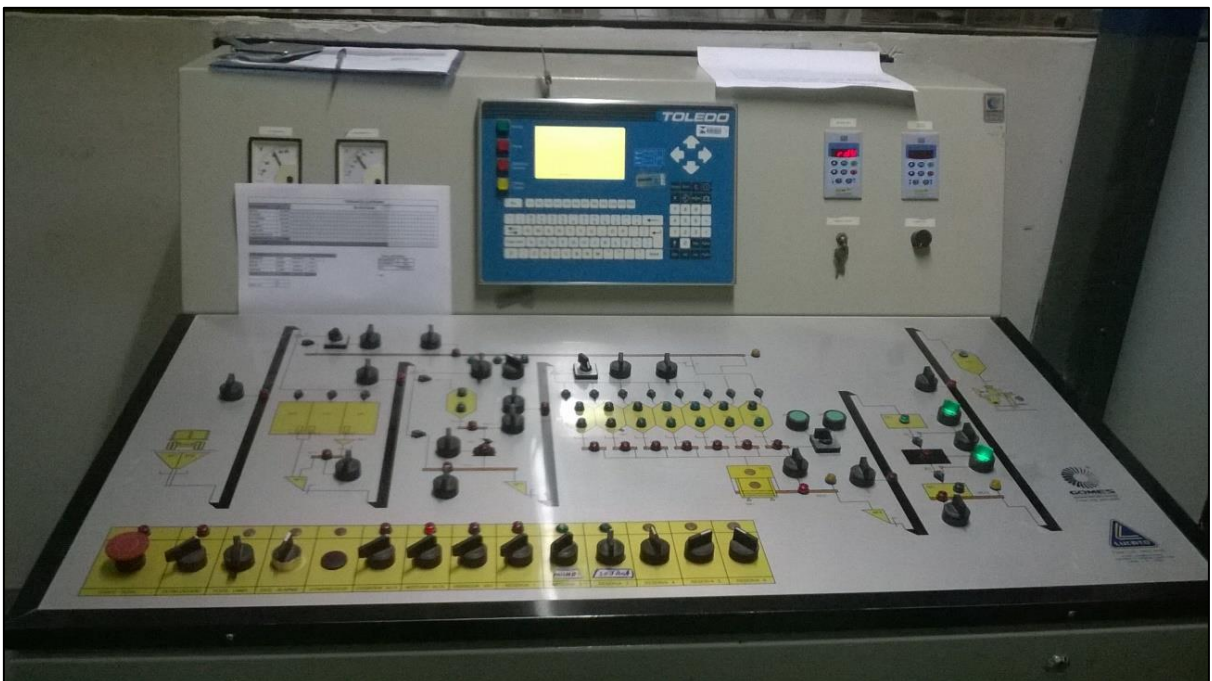
Figura 4 - Mesa-painel de controle dos equipamentos Terrafós, Araguaína-TO - Arquivo Pessoal (2016).
