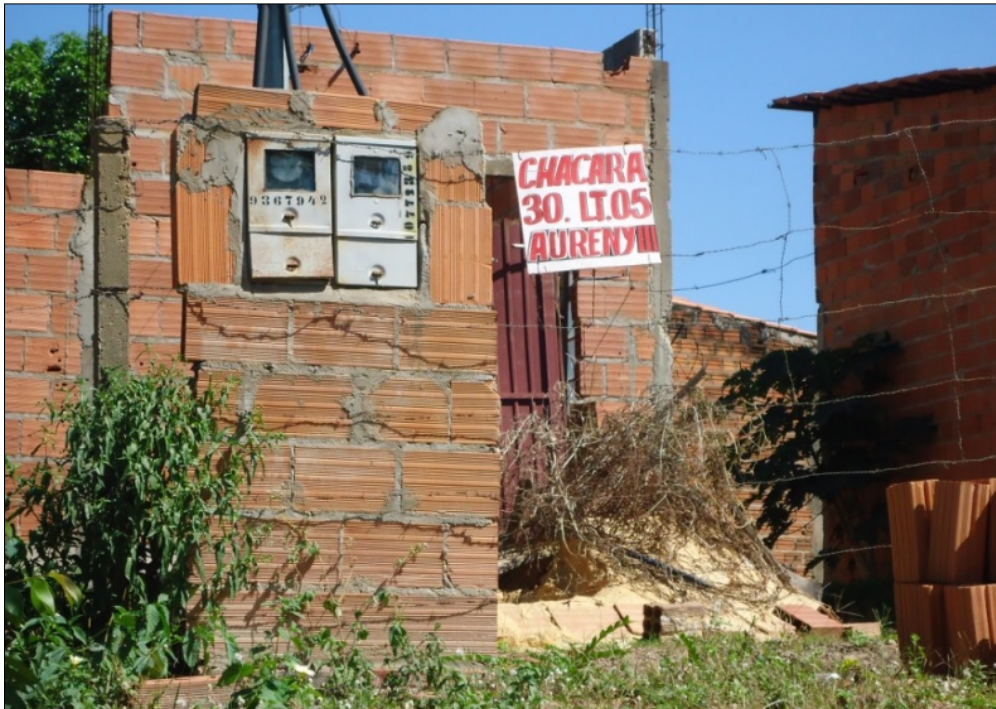
Figura 14 - Ocupação irregular com fornecimento de energia elétrica
