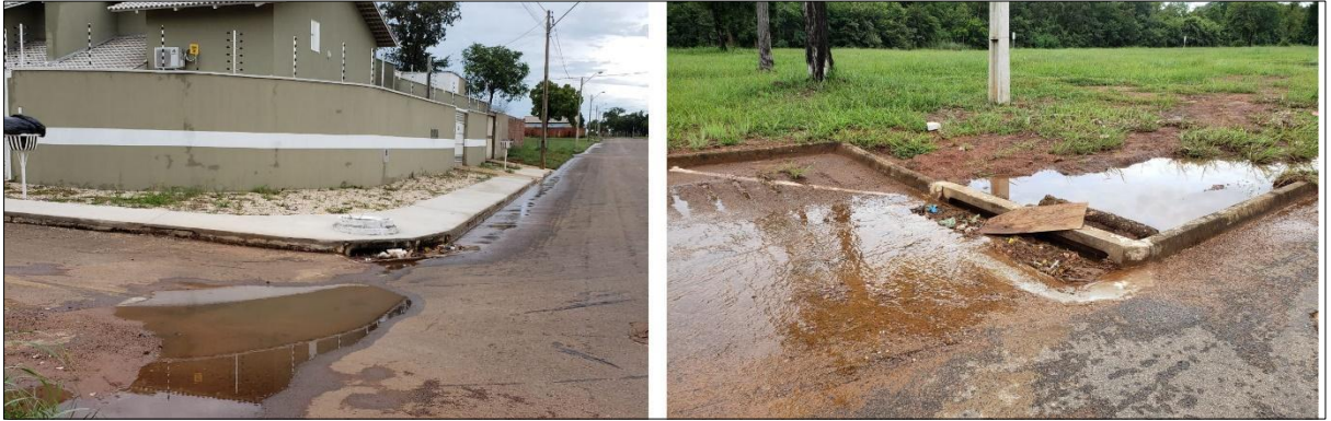
Figura 20 - Dispositivos de drenagem locados na confluência das sarjetas das esquinas da quadra 1.503 Sul de Palmas - TO.
