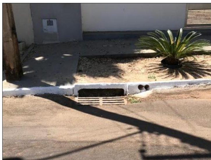
Figura 27 - Modelo de boca-de-lobo guia e grelha da quadra 404 Sul.
