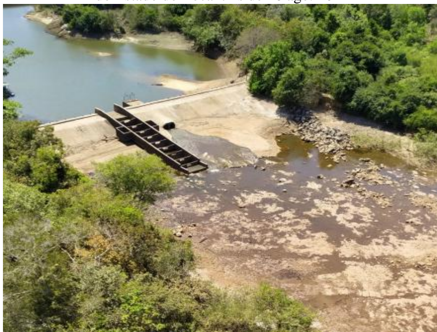
Figura 18 – Vista do barramento Eixo Tartaruga no Rio Urubu. Foto do Ministério Público do Estado do Tocantins de 16 ago. 2021
