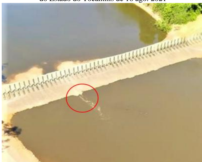
Figura 16 – Barragem Dois Rios. Não passa água por cima da base, apenas pela descarga de fundo circulada, sem mecanismo de aferição da vazão ecológica. Foto do Ministério Público do Estado do Tocantins de 16 ago. 2021
