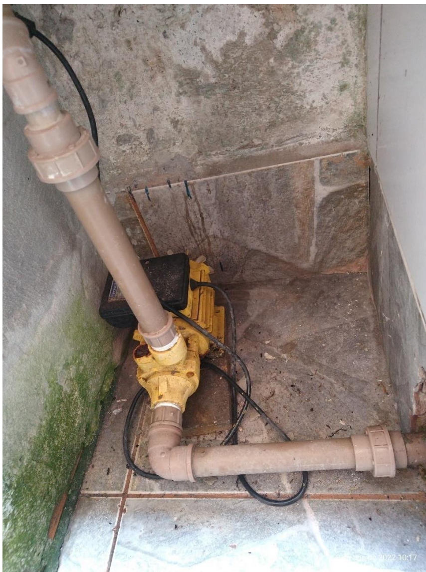
Figura 5: Bomba utilizada para abastecer a caixa d'água
