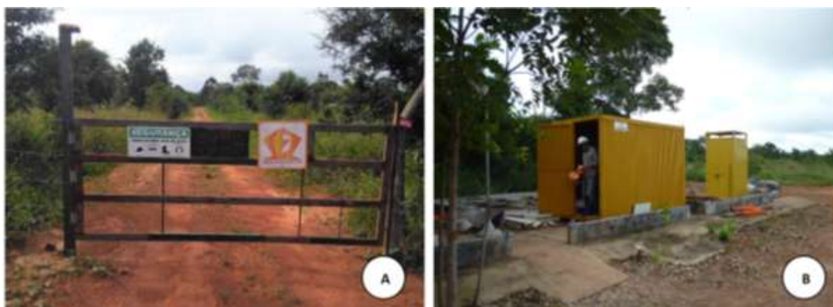
Figura 25 – A. Acesso à área de construção da ETE Lontra. B. Almoxarifado com EPI's.
