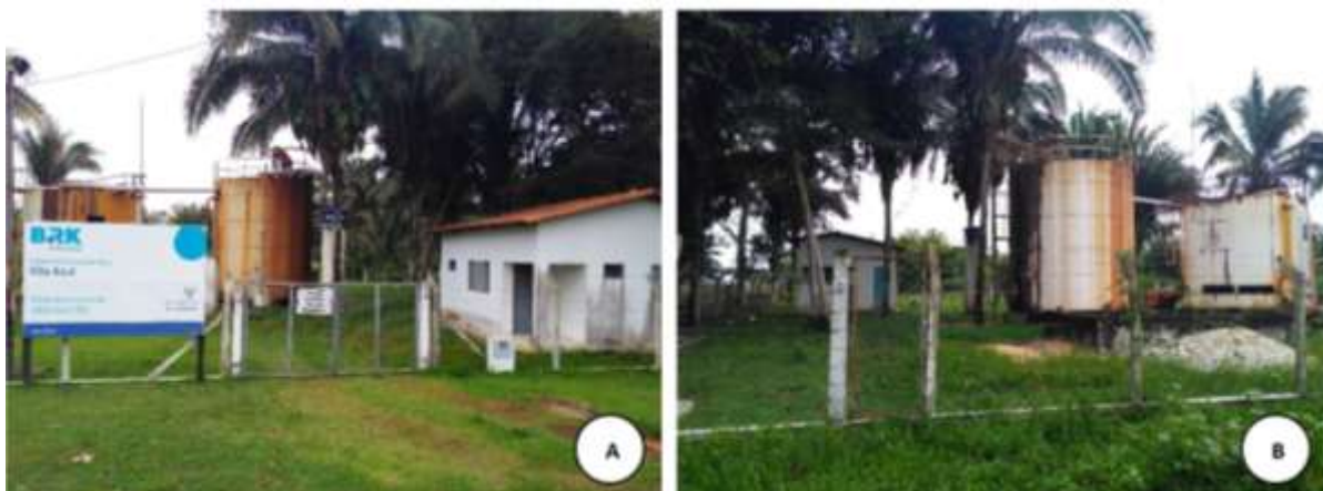
Figura 12 – Estação de Tratamento de Esgoto Vila Azul A. Vista frontal B. Vista lateral.
