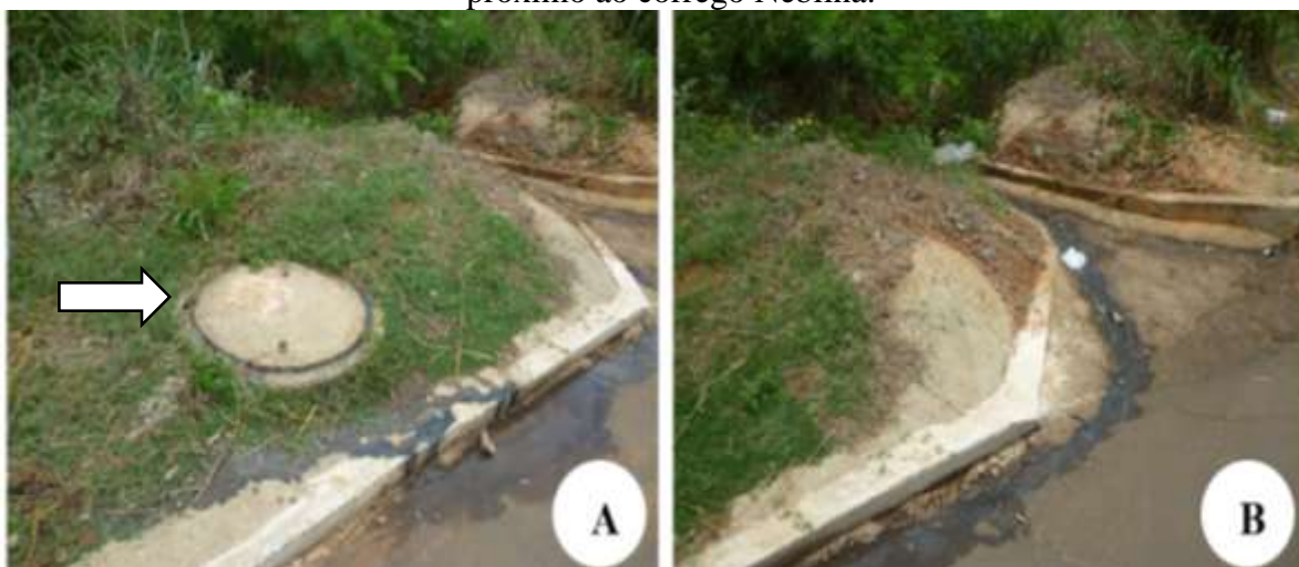
Figura 19 – A. Extravasamento de esgoto na Av. Neblina (seta). B. Esgoto a céu aberto próximo ao córrego Neblina.
