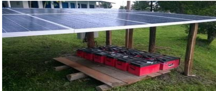
Figura 17: Sistemas off-grid com armazenamento de energia
