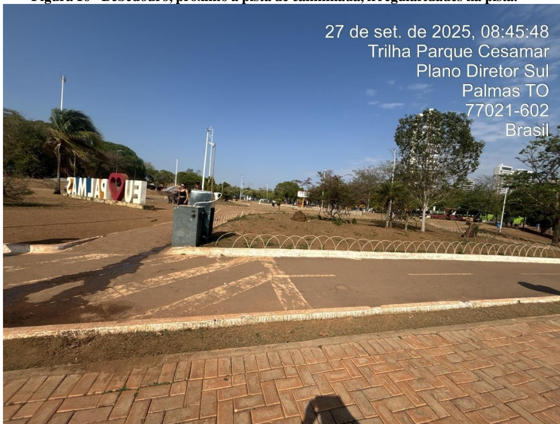
Figura 16 - Bebedouro, próximo a pista de caminhada, irregularidades na pista.
