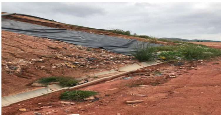
Figura 8 - Acúmulo de resíduos a céu aberto, erosões nos taludes e canaletas rompidas – CTR Ciclus
