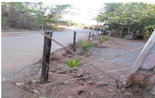
Figura 67 - Processos erosivos nas margens da estrada que dá acesso ao rio.
