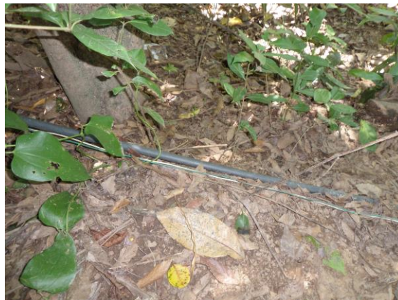
Figura 36 - Fios elétricos expostos próximos ao rio Azuis.
