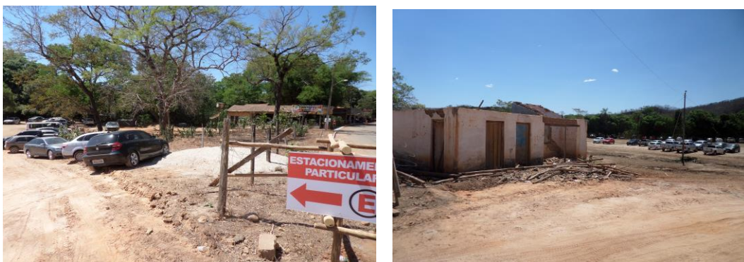
Figura 66 - Degradação ambiental na construção do novo estacionamento.
