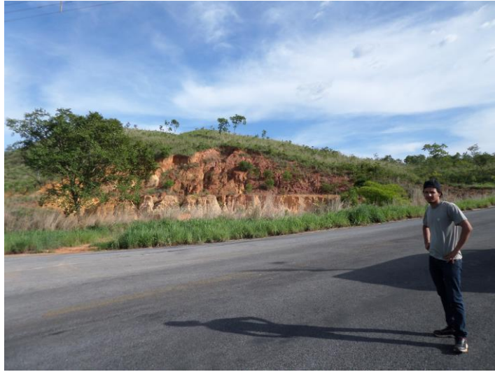
Figura 27 - Processos erosivos na entrada do balneário do Azuis.
