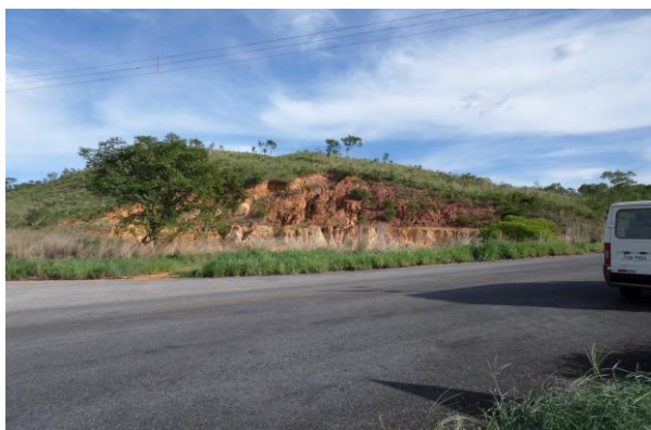
Figura 68 - Processos erosivos na entrada do balneário do Azuis.
