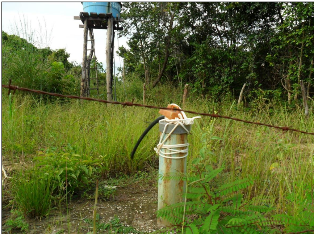
Figura 10 - Poço artesiano da Comunidade Angical
