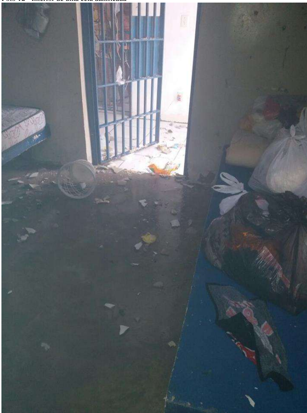
Foto 12 - Interior de uma cela danificada
