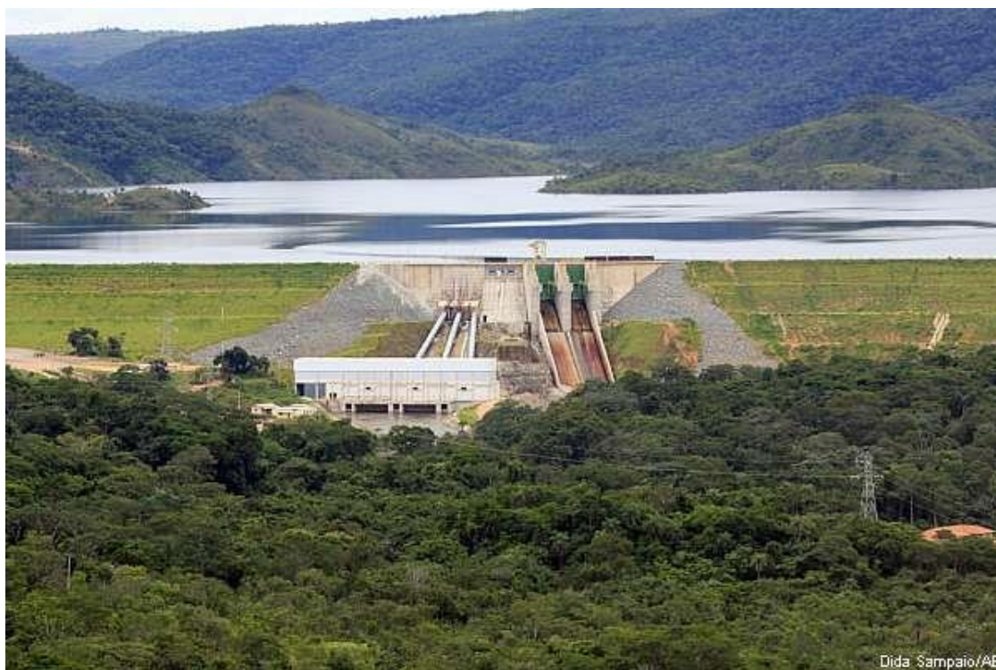
Fotografia 19 – Barramento da PCH Porto Franco (Fonte - Disponível em: < http://www.estadao.com.br/noticias/impresso,hidreletricas-destroem-cachoeiras-no-jalapao >. Acesso em: 29, set. 2011).
